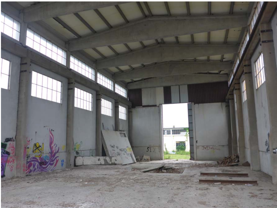
Abbildung 3: Alte Werkshalle im südlichen Teil des Geltungsbereiches. Auf den Betonträgern des Daches brütet regelmäßig ein Turmfalken-Brutpaar sowie Stadttauben (eigene Aufnahme am 17.05.2018)
